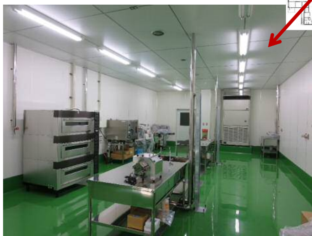
製品製造機器室内
